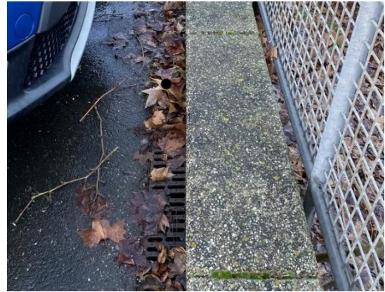
Mit Laub zugesetzte Einlaufrinne
