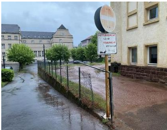
Zerstörte und ungeeignete Absturzsicherung
