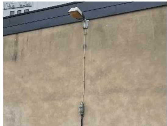
Veraltete Wandleuchte mit Zuleitung
