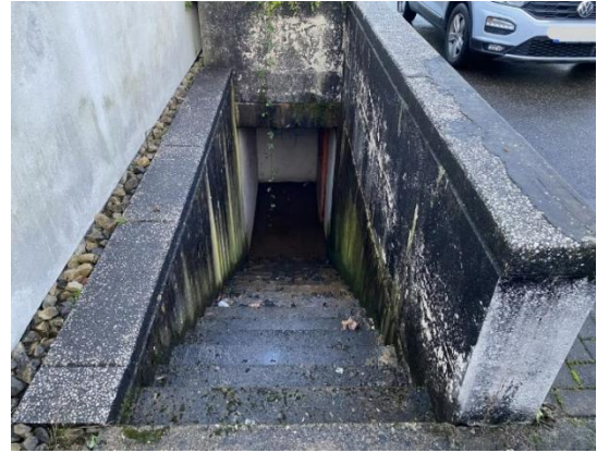
Flechten und Moose an Notausgangstreppe
